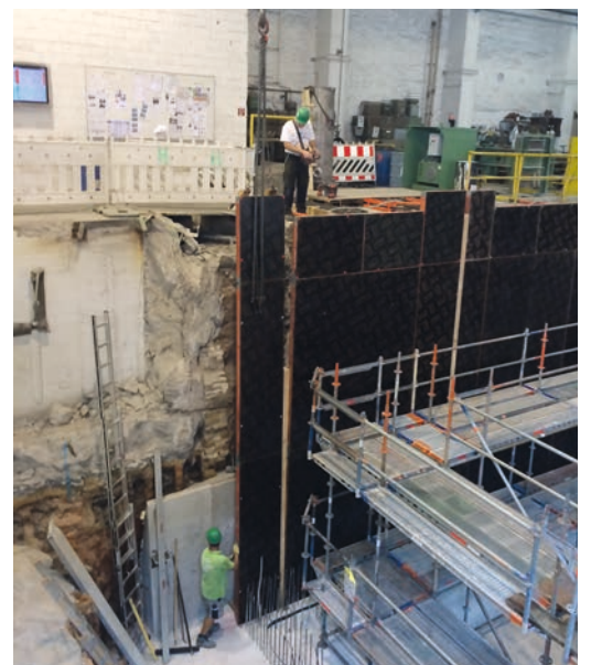
▼ Jürgen Otto und Matthias Häckel beim Aufbau der Wandschalung für den Umbau der Halle 15
