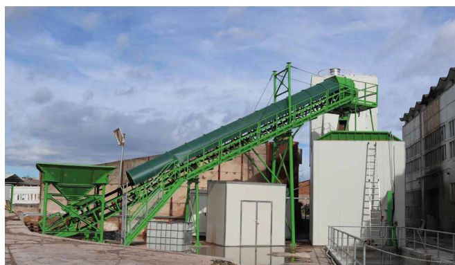
Blick auf die Beschickereinheit der neuen Mischanlage
