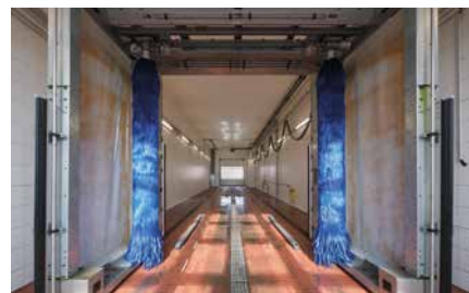
Innenansicht der Portalwaschanlage für Elektrobusse
